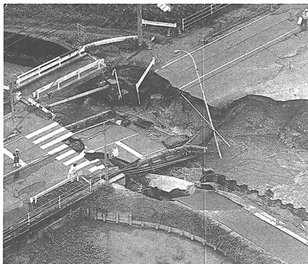
写真 1 崩落した国道 155 号の東橋（知多市）
